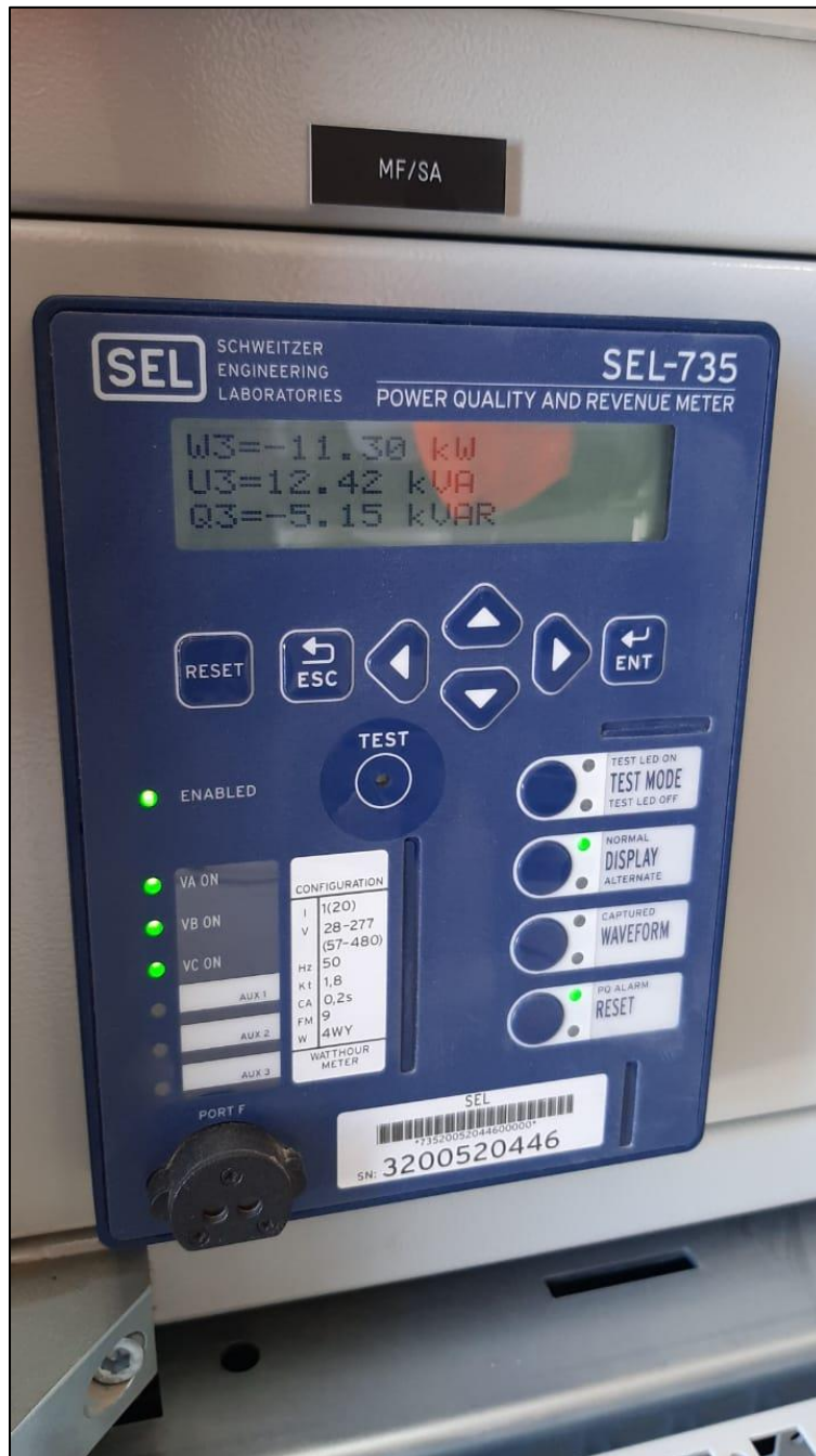
Figura 9-5 Registro 4 potencia activa SSAA.
