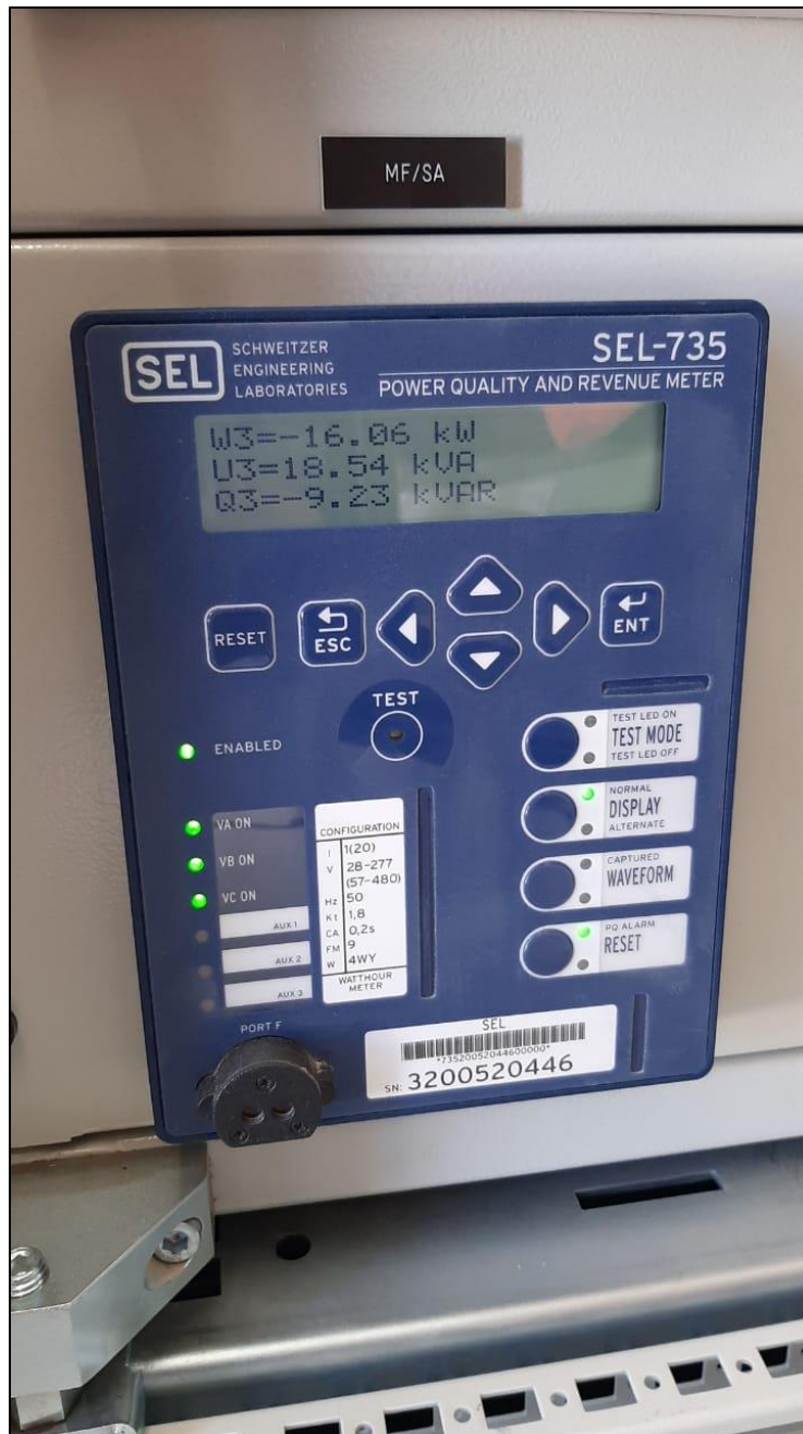
Figura 9-7 Registro 6 potencia activa SSAA.
