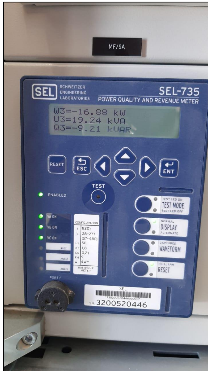
Figura 9-2 Registro 1 potencia activa SSAA.
