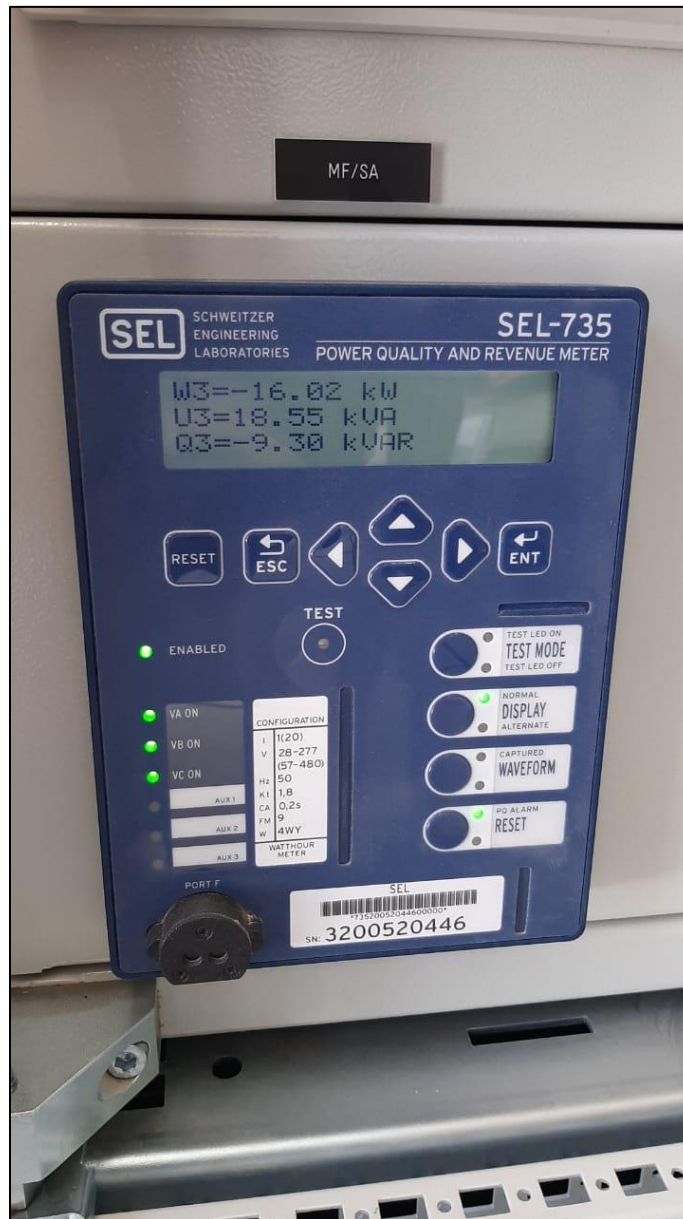
Figura 9-3 Registro 2 potencia activa SSAA.
