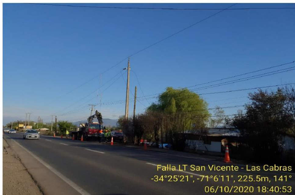
Imagen N° 1: Imagen muestra zona afectada de quema en vano 16 – 17 e instalación LT66kV San Vicente TT – Las Cabras sin conductor producto del daño
