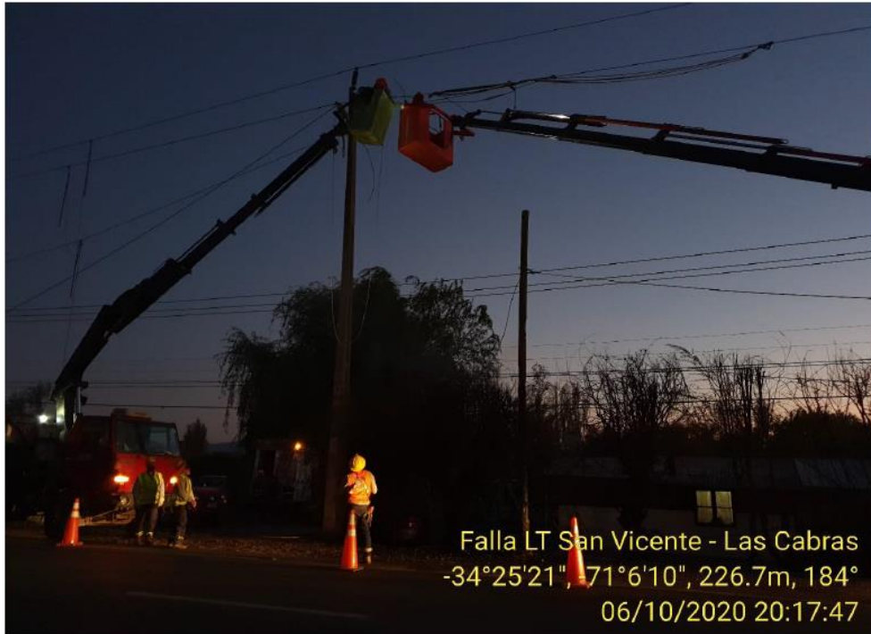
Imagen N° 3: Imagen muestra personal realizando labores de reparación de conductor cortado en vano 16 – 17 LT66kV San Vicente TT – Las Cabras
