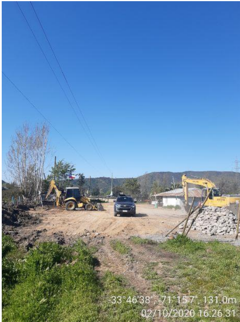
Fotografía 1: Vista hacia el norte de Vano de Línea entre Est. 50-51 de LT 66kV Chocalán – Mandinga, donde se aprecian dos maquinarias pesadas, 1 máquina retroexcavadora y 1 máquina excavadora con oruga.
