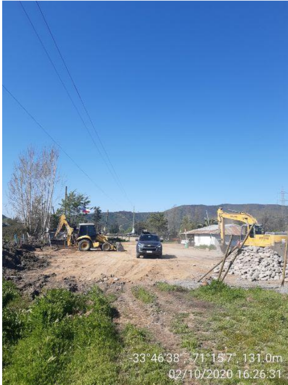
Foto N°1: Vano entre estructuras N°50 y 51 de la LT 66kV Chocalán – Mandinga, se evidencia de presencia de maquinaria pesada en la zona de falla.
