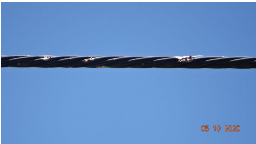
Foto N°3: Detalle del daño causado en la fase C del conductor.
