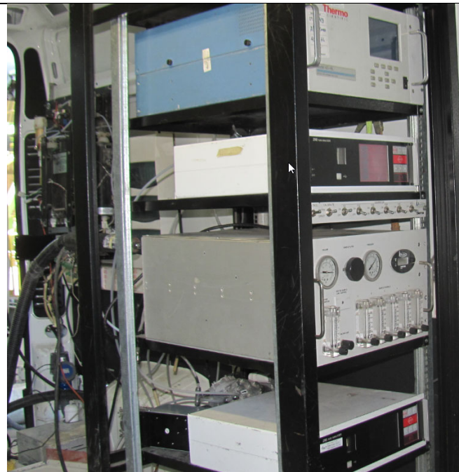
Figura 4-11 Instalación Analizadores de Gases
