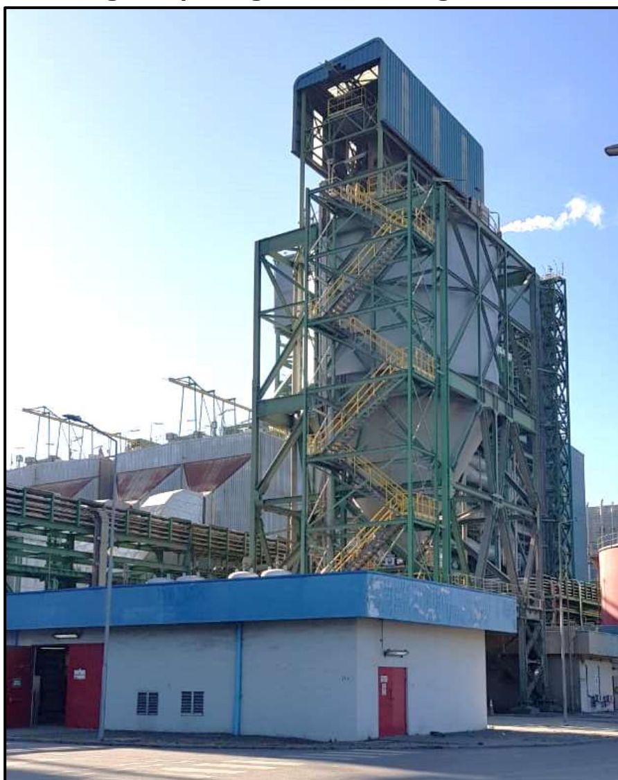
Figura N° 1 Fotografía plano general Caldera generadora
