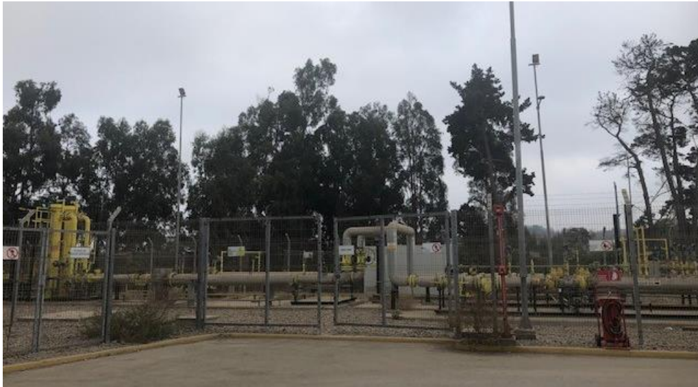
Figura 2 ERM Cogeneradora Aconcagua
