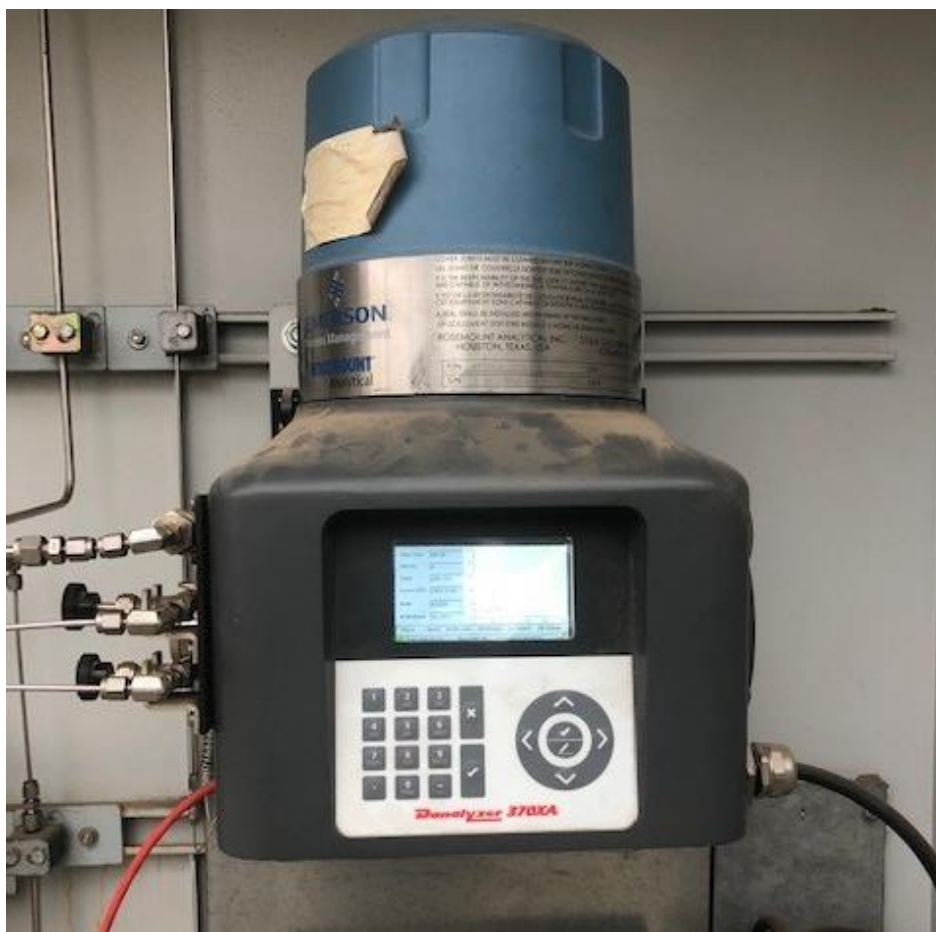
Figura 4 Cromatógrafo 370XA Emerson. A la izquierda se pueden apreciar las 3 tomas del equipo
