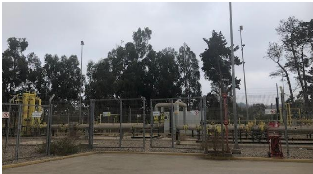
Figura 2 ERM Cogeneradora Aconcagua
