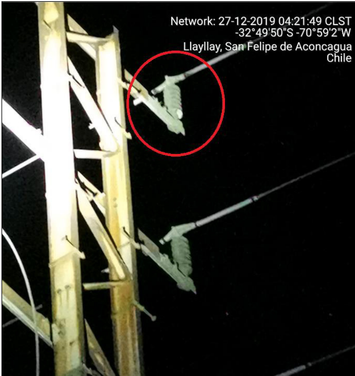
Figura 3: Estructura N°29 de la Línea 44 kV Las Vegas-Los Andes. Aislador con descarga eléctrica por el Circuito N°1.
