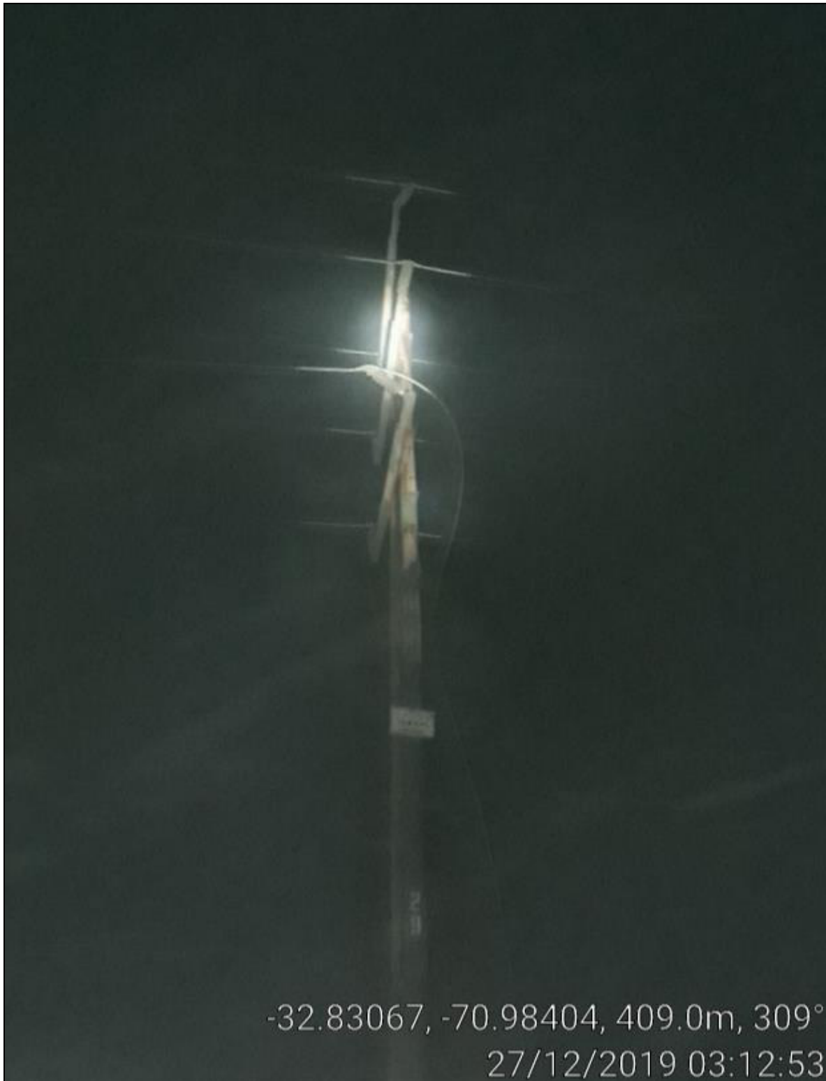
Figura 2: Estructura N°29 de la Línea 44 kV Las Vegas-Los Andes. Corte de conductor por el Circuito N°2, debido a la dilatación por el exceso de calor provocado por incendio.
