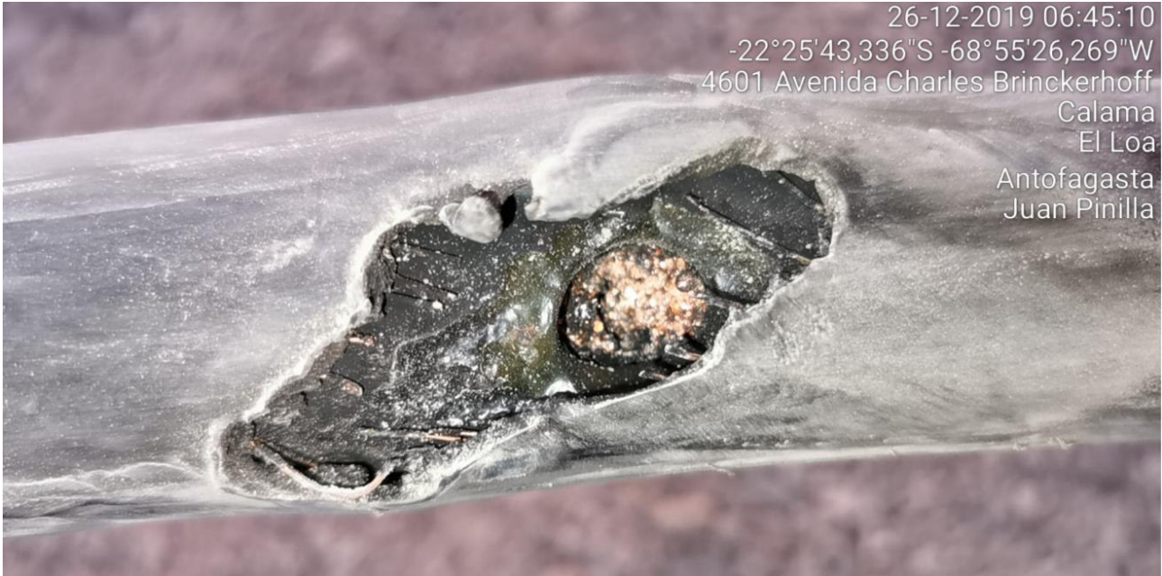
Fotografía N°3 Aislación afectada en la falla
