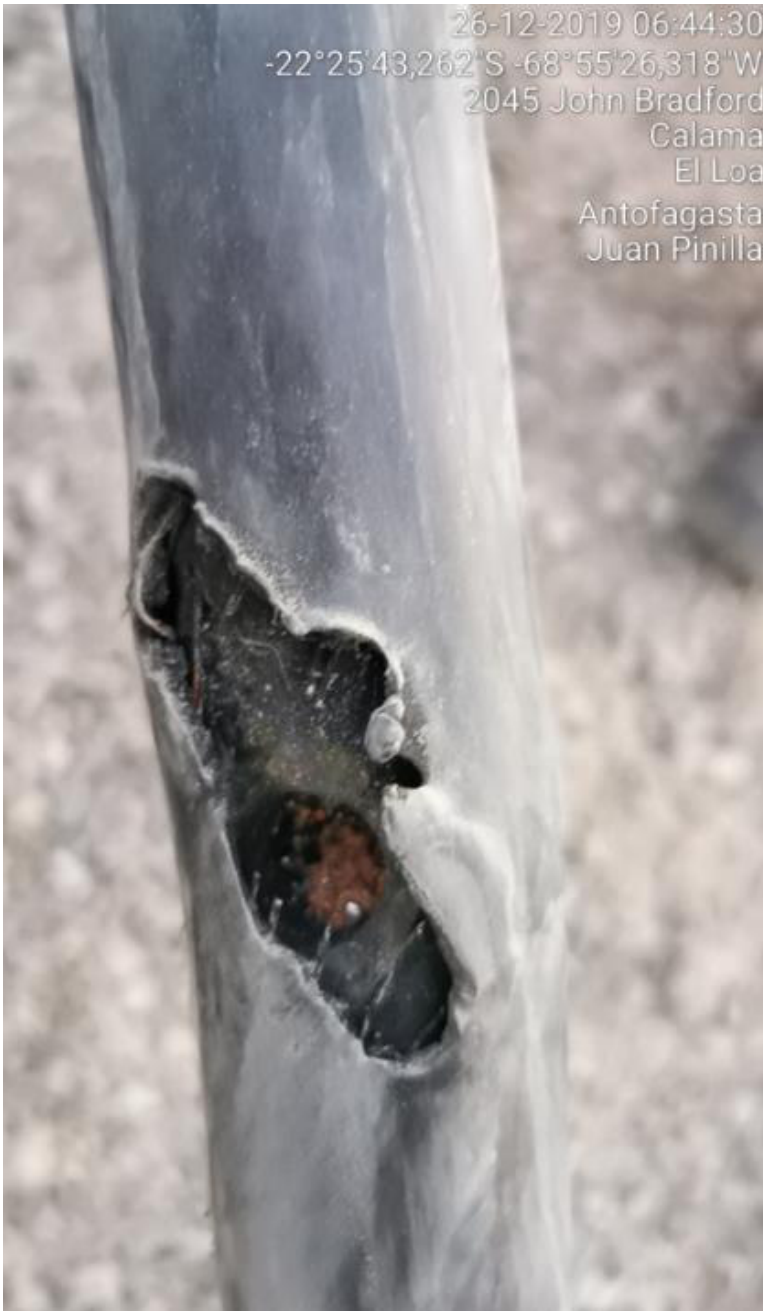
Fotografía N°1 Conductor fase 1 con daño en aislación
