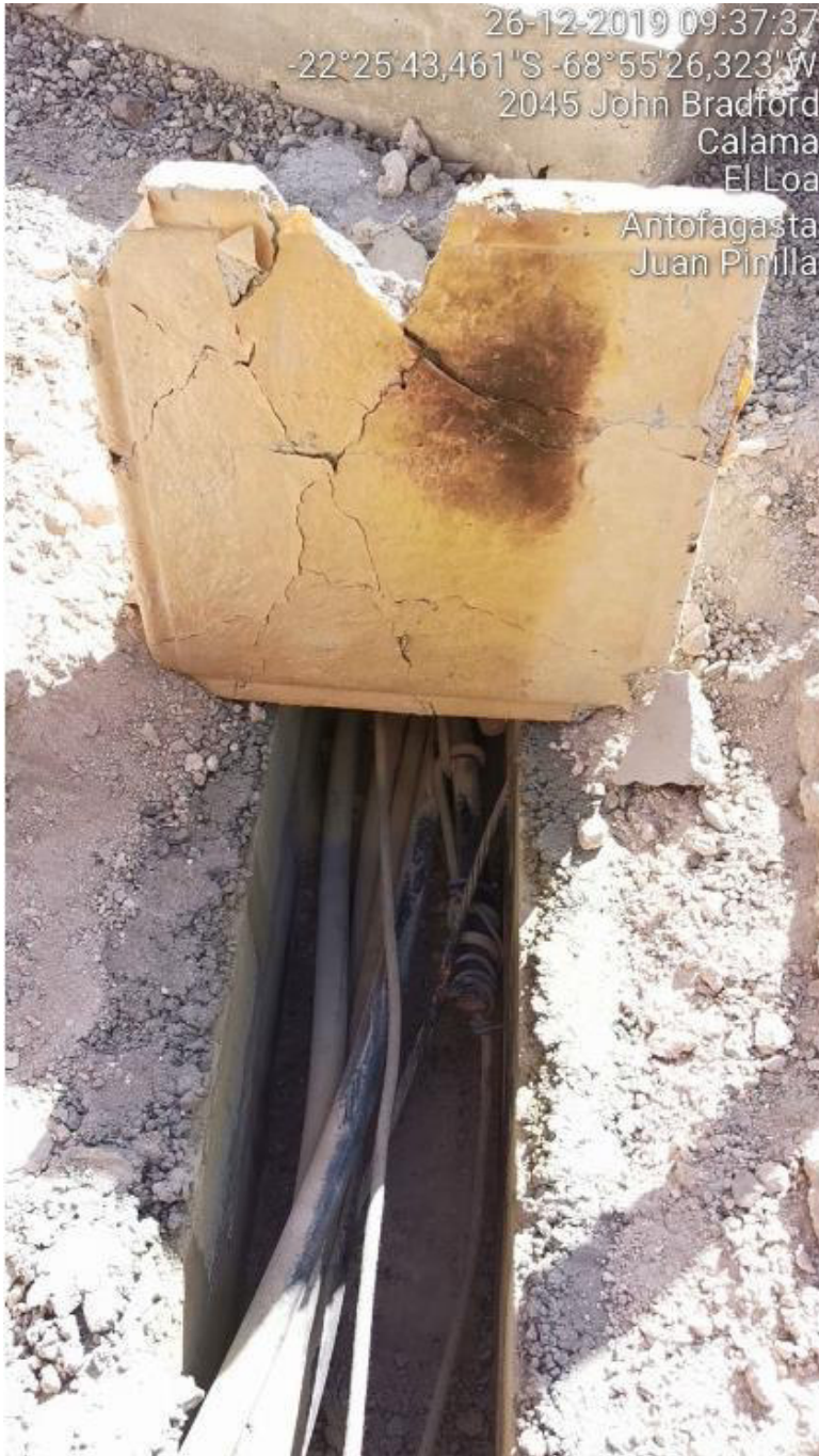
Fotografía N°2 Sector falla conductor
