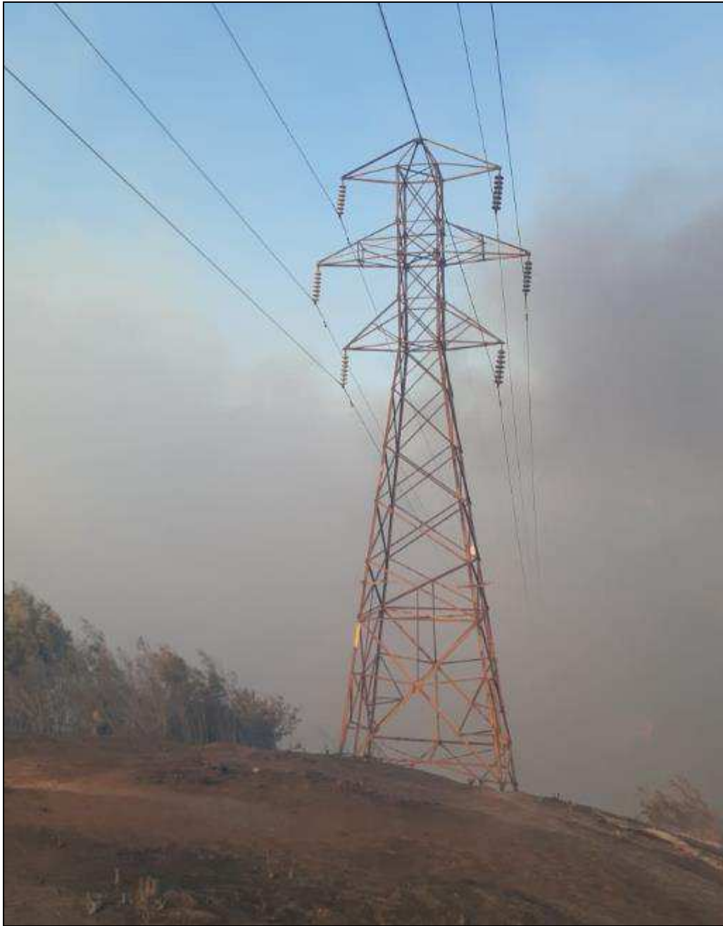
Figura 1: Estructura N°42 Línea 110 kV Laguna Verde-Agua Santa. Vista del incendio, fenómeno físico de la falla, hacia la estructura N°43.
