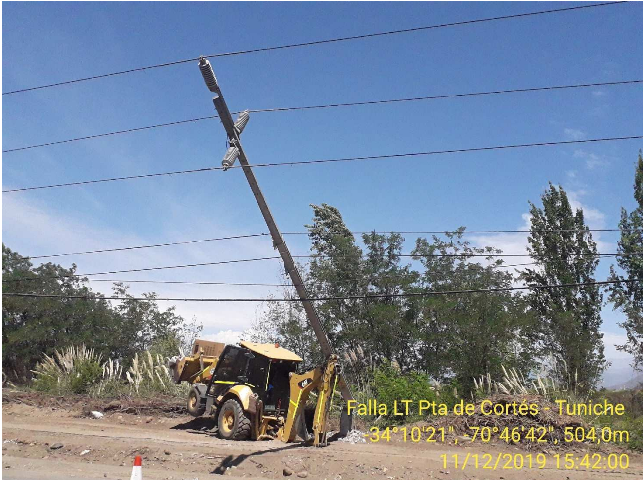
Imagen 1.- Condición E72 resultante del choque de la retroexcavadora
