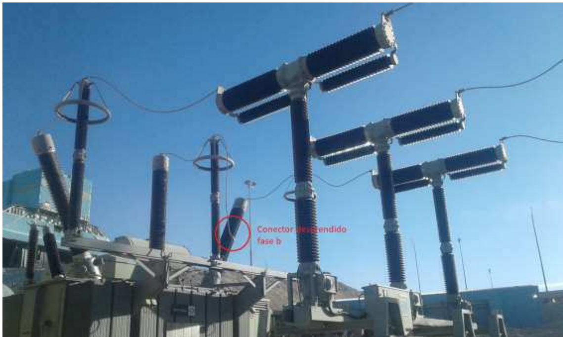
Figura 2: Corte del conductor fase b, entre 52JT2 y el pararrayos del T2.
