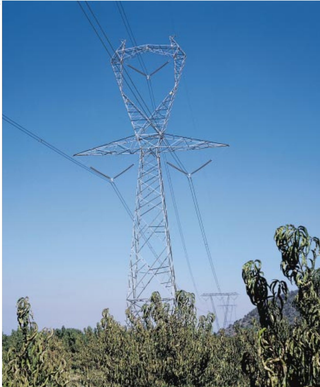
Línea de Transmisión Ancoa - A. Jahuel 500 kV, cto 1. Longitud: 240,51 Km.
