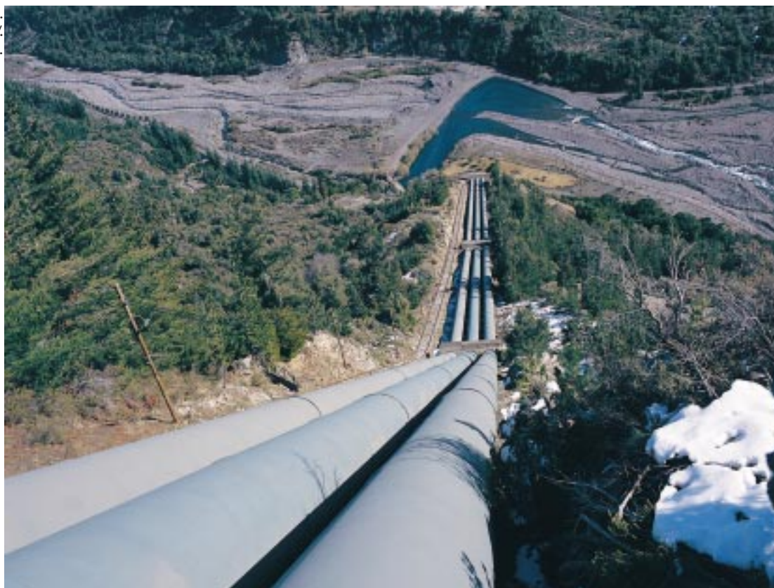
Central Hidroeléctrica Cipreses. Potencia Instalada: 101,4 MW. Ubicación: Linares, VII región.
