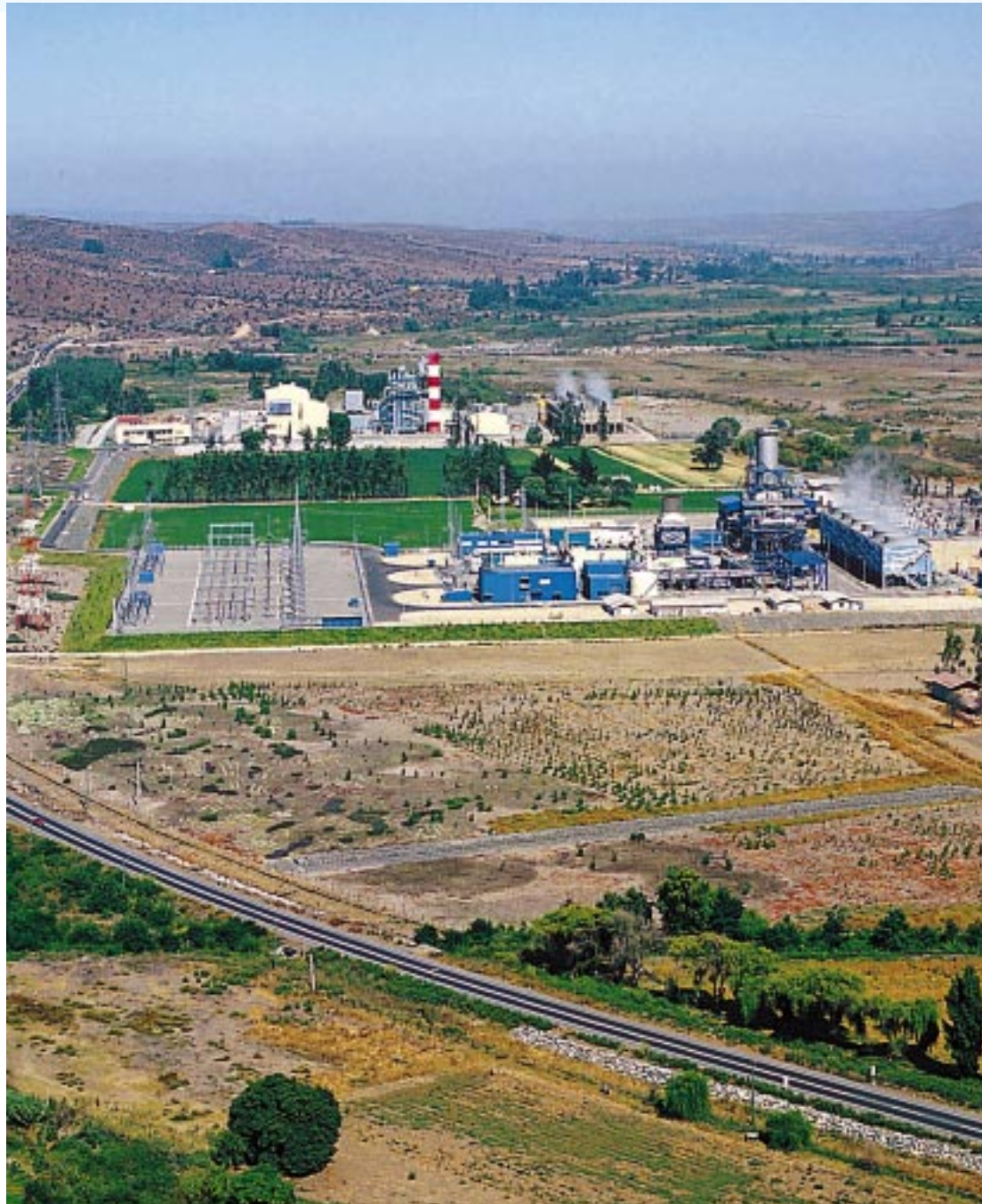
Centrales de Ciclo Combinado San Isidro y Nehuenco. Potencia Instalada: 740 Mw. Ubicación: Quillota, V región.
