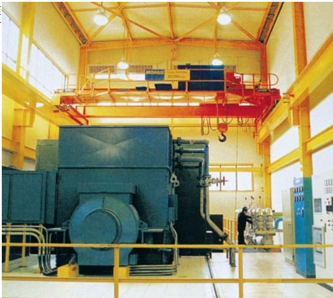
Central Termoeléctrica Arauco. Potencia Instalada: 101,3 Mw. Ubicación: Arauco, VIII región.
