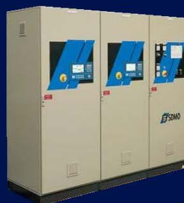
Armario de control mando 2 x 2000 kVA
