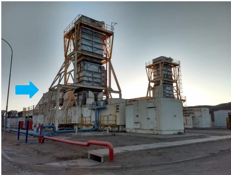
Figura 2: Central Emelda, a la izquierda Unidad 02 y derecha Unidad 01.
