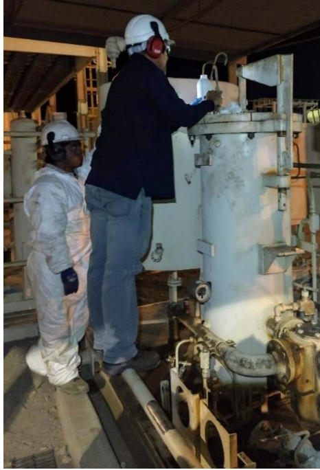
Figura 10: Toma de muestras de combustible desde arranque ubicado en filtros de combustible.
