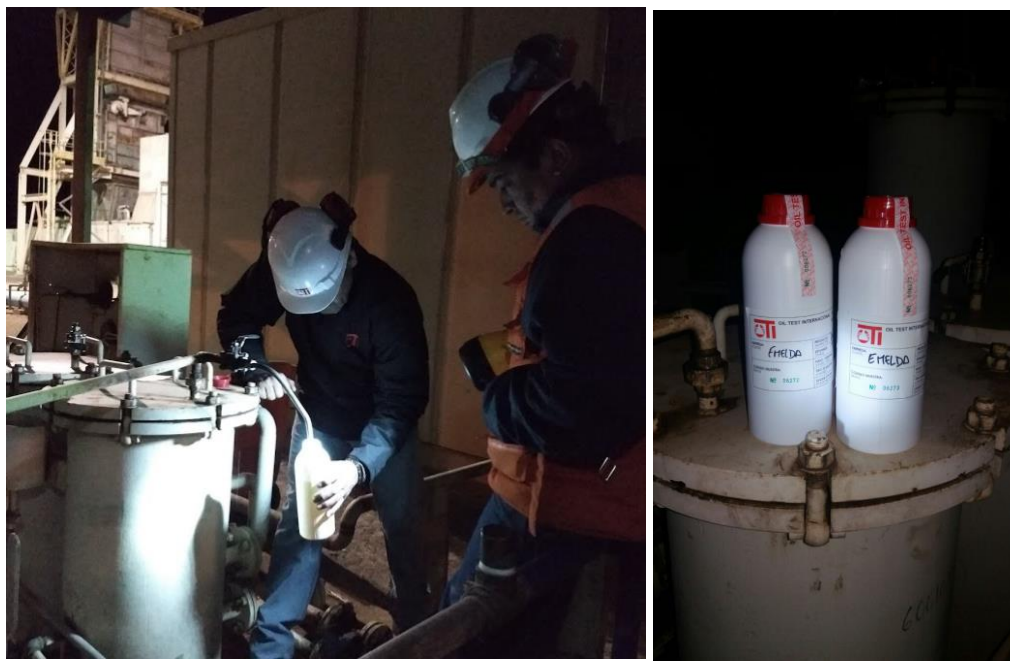
Figura 9: Toma de muestras de combustible desde arranque ubicado en filtros de combustible.
