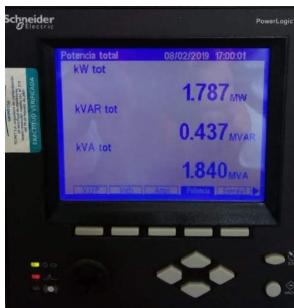
Figura 3: Medidor de potencia neta de la central
