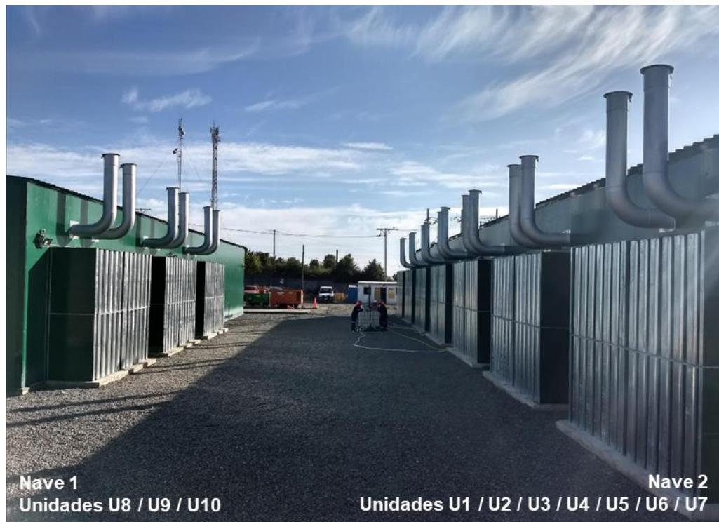
Figura 1: Central Quellón II, a la izquierda Nave 1 y derecha Nave 2.
