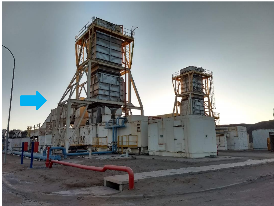
Figura 1: Central Emelda, a la izquierda Unidad 02 y derecha Unidad 01.
