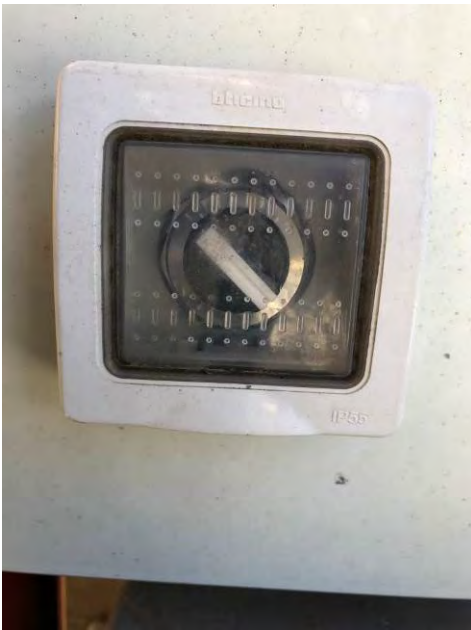
CO2 BANK SELECTOR SWITCH
