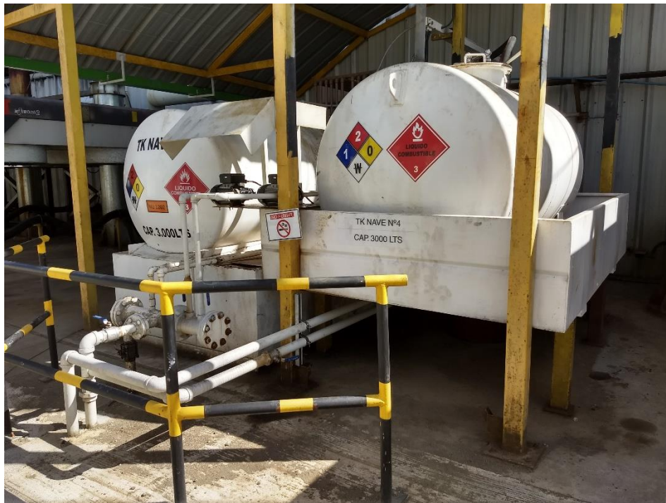
Figura 9: Tanque Diario Nave 4 (derecha)
