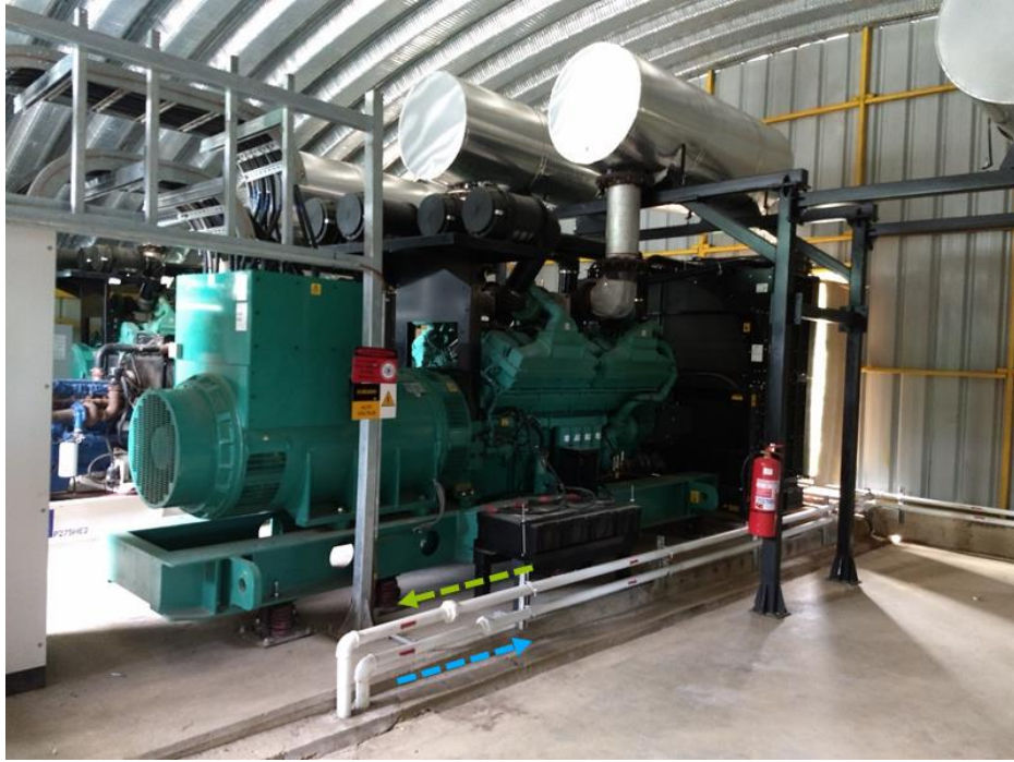
Figura 1: Unidad 24 de la Central Degañ 2. A nivel del piso se indican las líneas de combustible principal: Alimentación y Retorno.
