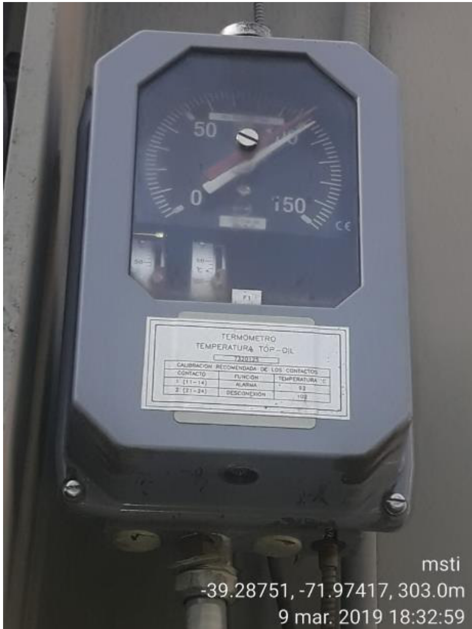
Fotografía N°1: Indicador de temperatura aceite encontrado.
