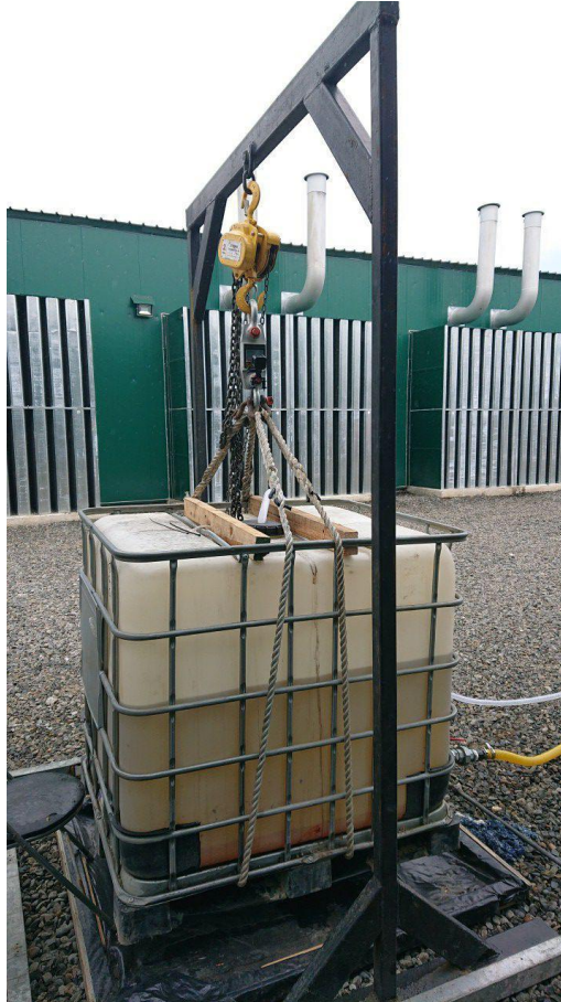
Figura 4: Instalación auxiliar para medición de consumo de combustible por peso.
